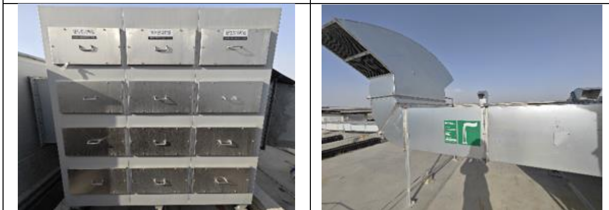
实验中心 Px-13 排气筒前端“活性炭吸附”装置
