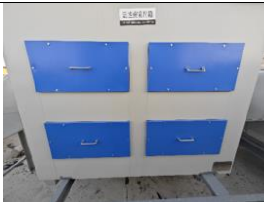
P27 排气筒前端“活性炭吸附”装置
