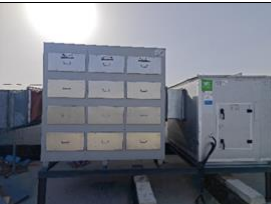
实验中心 Px-1 排气筒前端“活性炭吸附”装置
