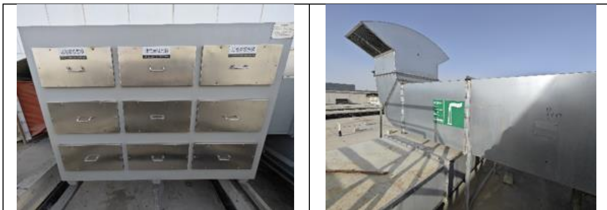
实验中心 Px-12 排气筒前端“活性炭吸附”装置
