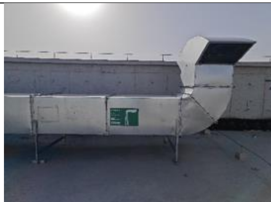
实验中心 Px-1 排气筒
